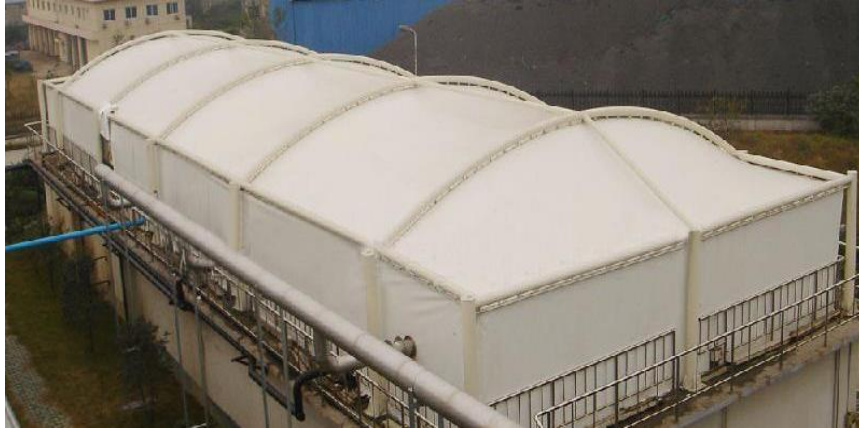
图 12 污水处理装置加盖板封闭回收 VOCs
